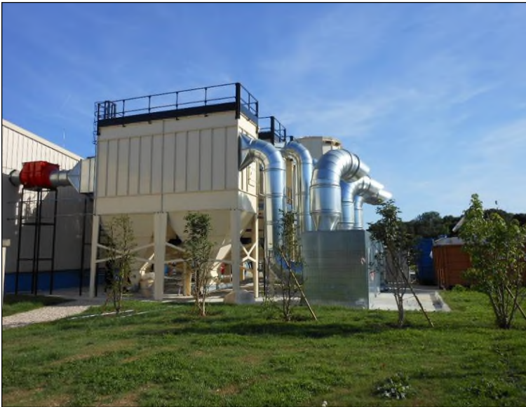
Plateforme Ouest - Dépoussiéreurs
