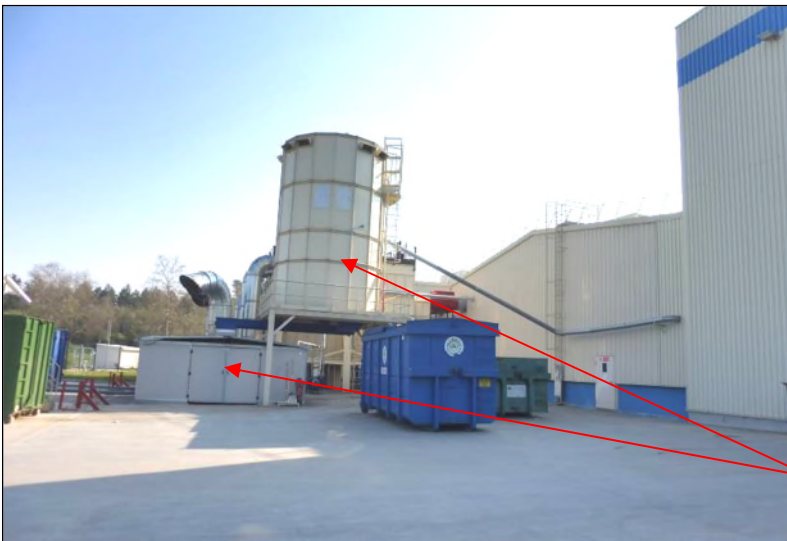
Trémie tampon et cabine de compactage
