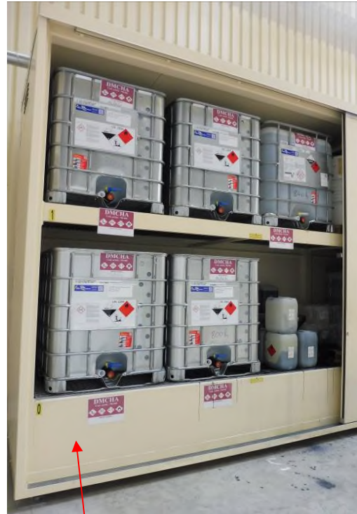
Bacs rétention armoire DMCHA
