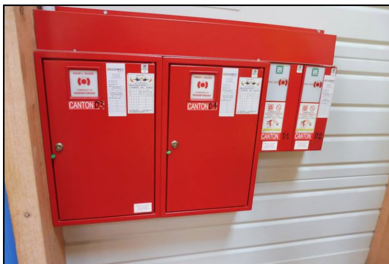
Commande de désenfumage
