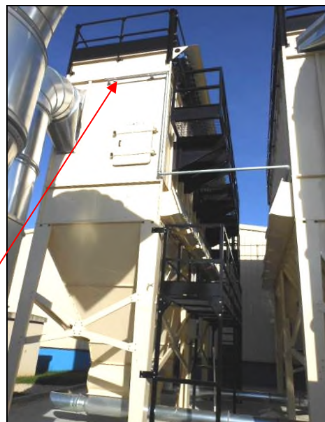
Rampe d'extinction sur filtre
