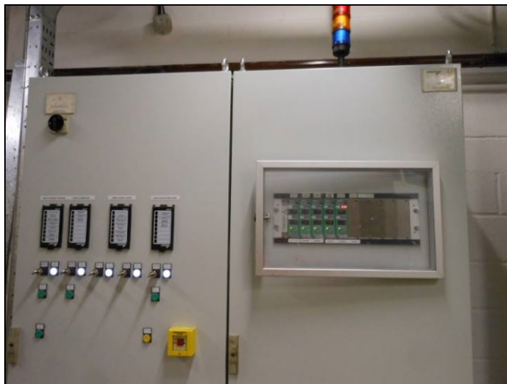
Centrale détection pentane – ligne PU-A
