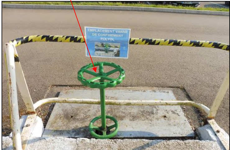
Vanne rétention aire de dépotage polyol
