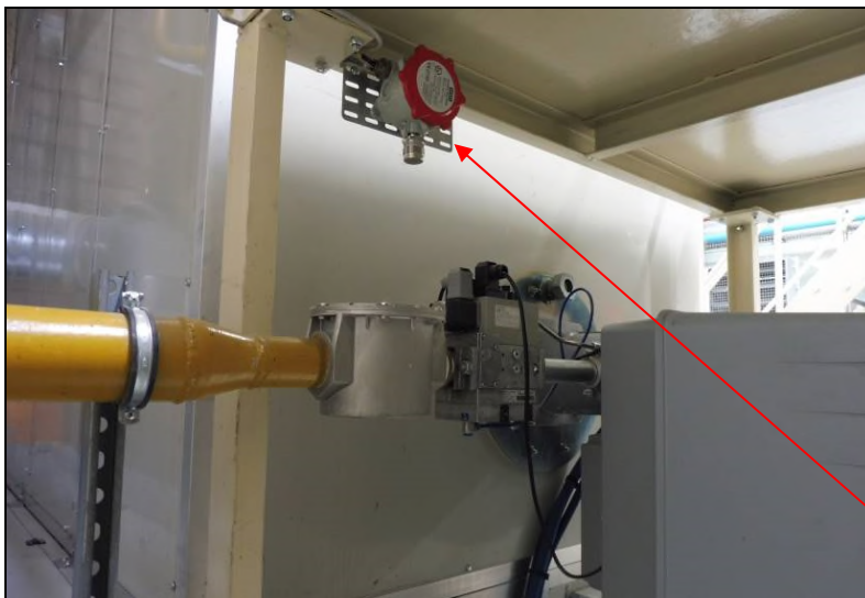
Détecteur gaz brûleur générateur d'air chaud
