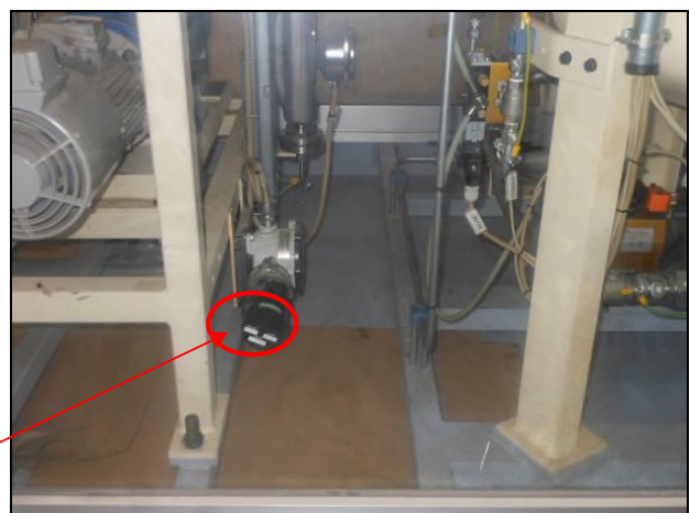
Détecteur cabine dosage
