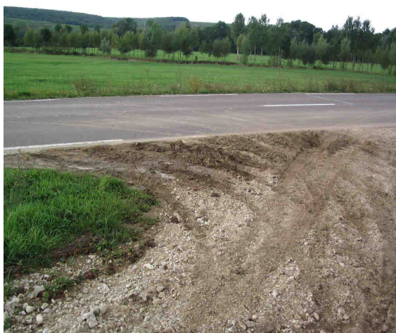
Lors des fortes pluies, ruissellement et coulées de boues sur la RD 91 au niveau de « l'Homme-mort »(12)
