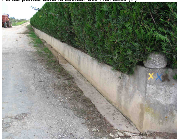
Niveau de hauteur d'eau inscrit sur le mur lors de l'événement exceptionnel dans le chemin de Beaune (8)
