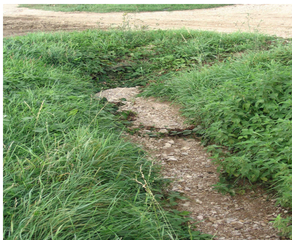
Problème d'entretien des fossés et des réseaux d'assainissement liés au ruissellement viticole dans le secteur de « l'Homme-mort »(12)
