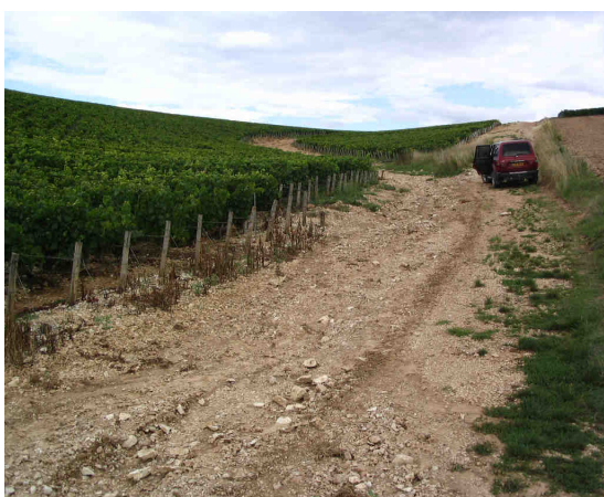
Chemin dégradé suite au ruissellement dans les vignobles au niveau du secteur des Pierrettes (7).
