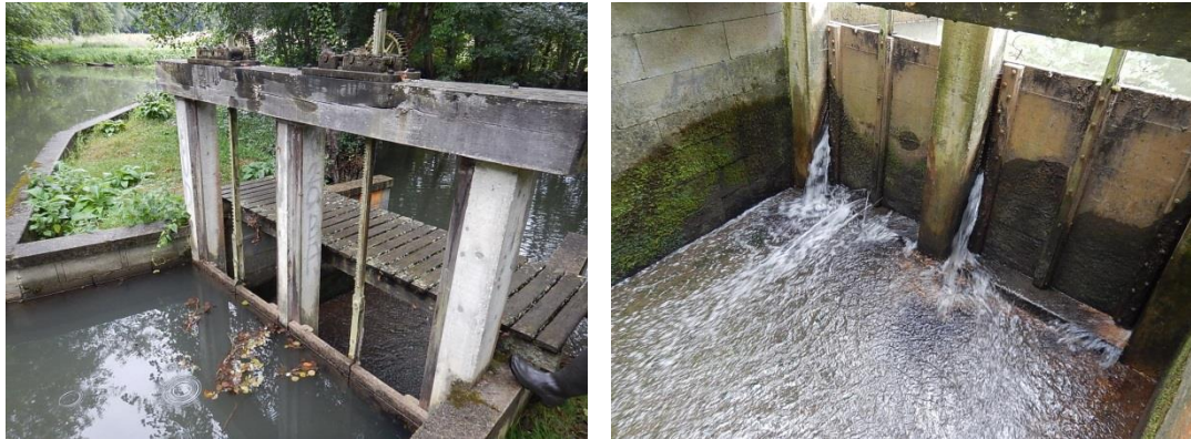
Fig. 5. Vannage de décharge sur l'ouvrage partiteur amont
