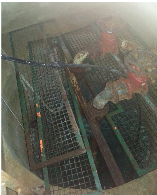
Figure 3-2 : Vue de l'intérieur du puits : plateforme de travail et pompes (source : SAFEGE, 2014)
