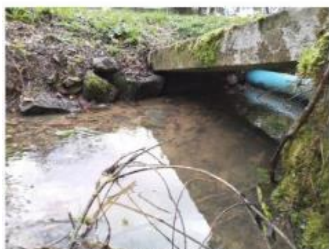
Traversée d'une conduite fonte
