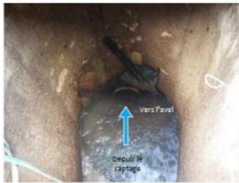
Arrivée des eaux vers un cuvelage de dissipation puis vers une conduite en fonte DN 200
