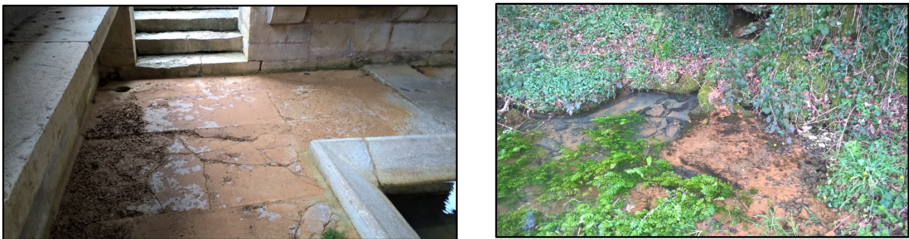
Figure 15 : Dépôts de fines au lavoir et à la source d'Avrigny
