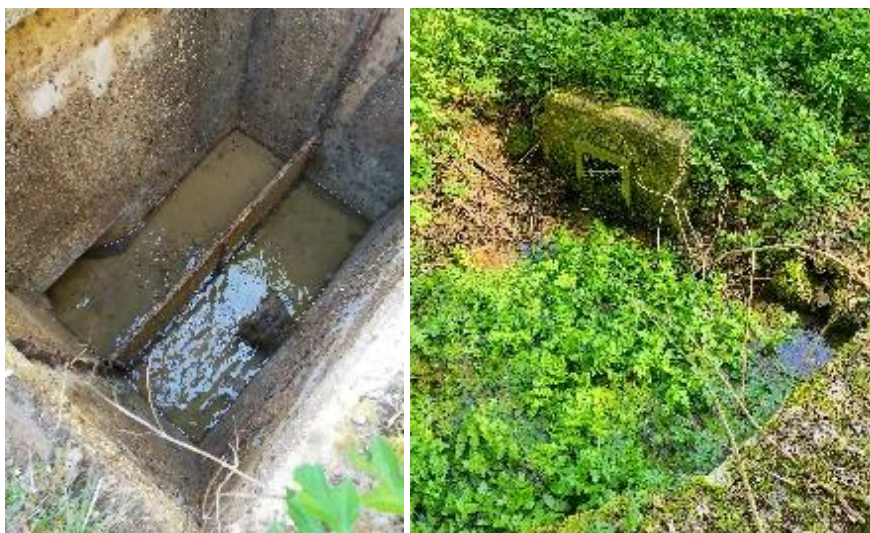
Figure 10 : regard en béton avant le trop-plein des eaux en direction du ruisseau du Chamoux (à gauche) et exutoire du trop-plein (à droite)
