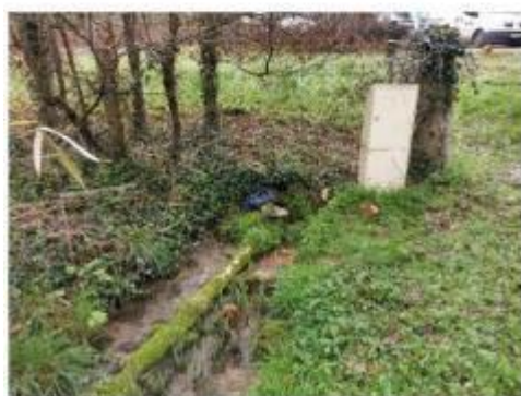
Sortie/ exutoire du trop-plein en acier DN 300 (conduite acier visible dans le cuvelage)
