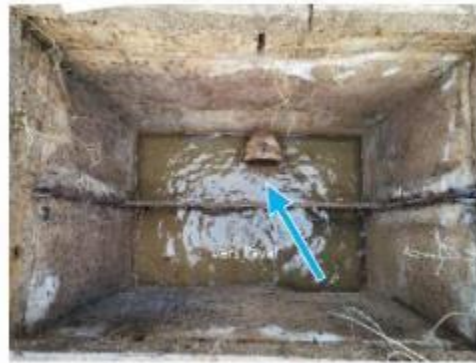
Passage de l'eau au travers d'une maille acier puis vers une conduite en fonte DN 150
