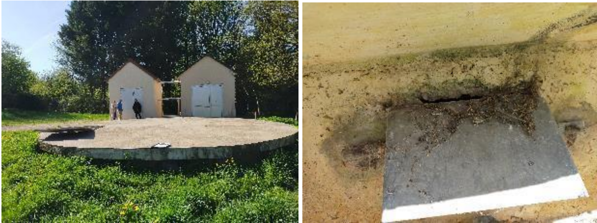
Figure 4 : vue du captage de la source de la Claimpie en surface et détail de l'un des 4 événements
