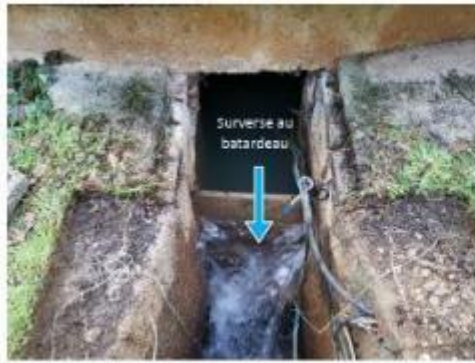
batardeau de régulation du débit de fuite du captage :
