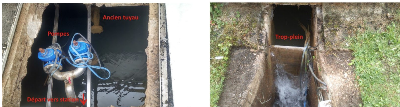
Figure 10 : Photos des pompes et d'un trop-plein du captage
