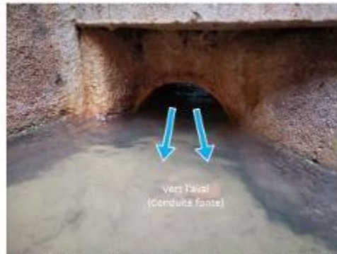
Arrivée de l'eau depuis le cuvelage de dissipation par une conduite fonte DN 200
