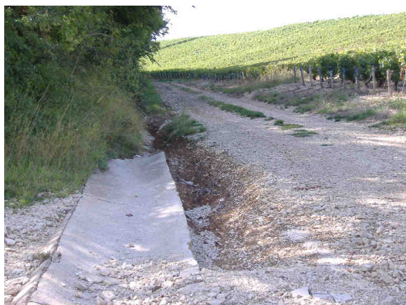
Aménagement détérioré du fait de l'érosion (85)
