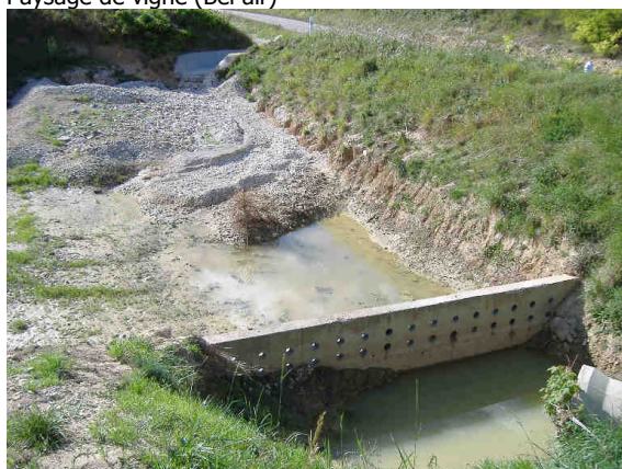
Piège à cailloux (53) le long de la D62
