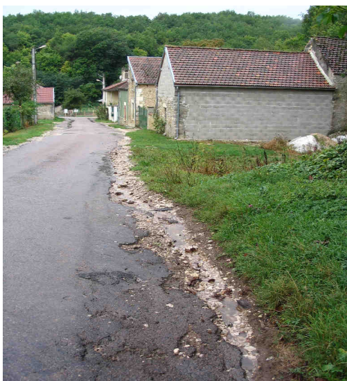
Dans le secteur du Rameau, forts ruissellement sur la voirie
