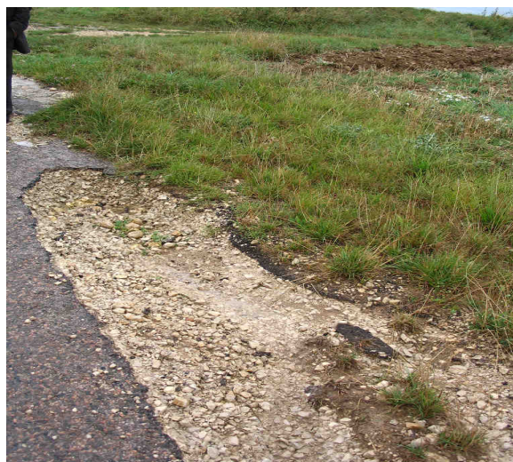
Dans le Secteur de Vau Rémy, Ornières créées par le ruissellement
