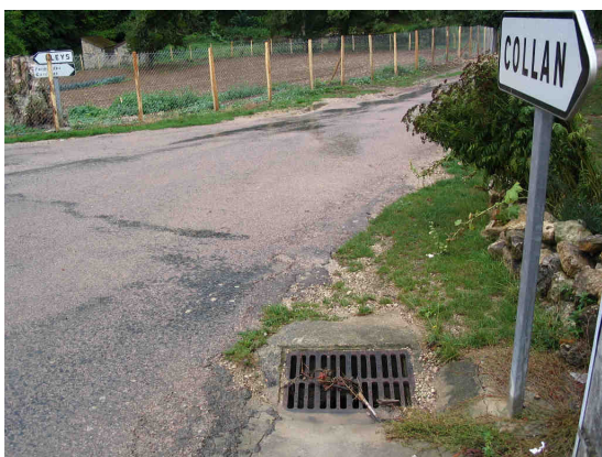
Dans le secteur du Rameau, Grille d'avaloir qui se bouche lors des fortes pluies, inondations créées au niveau du carrefour.
