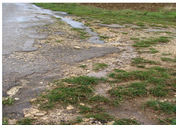
Dans le Secteur de Vau Rémy, Ornières créées par le ruissellement
