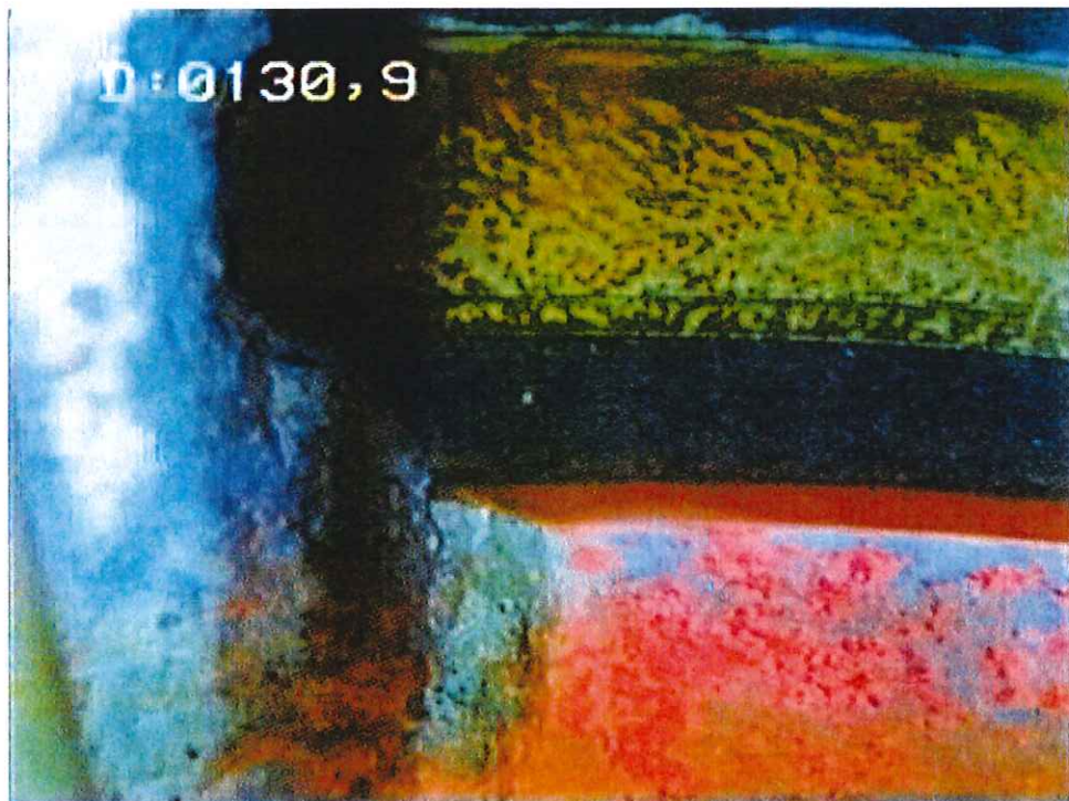
14- Tubage acier plein – base du sabot, ciment
