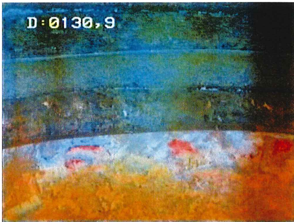
13- Tubage acier plein – base du sabot, ciment
