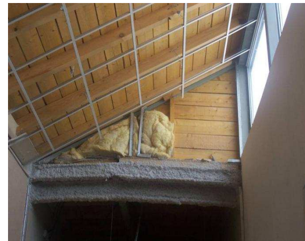
Mauvaise mise en place de l'isolant sans continuité du pare-vapeur
