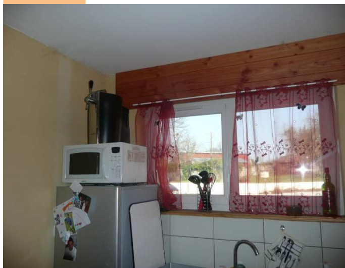
Entrée d'air dans une pièce de service
