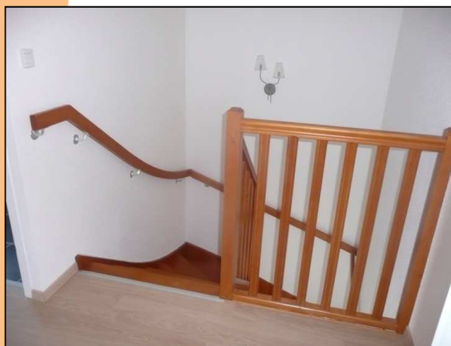
Prolongation main courante ou rampe d'escalier
