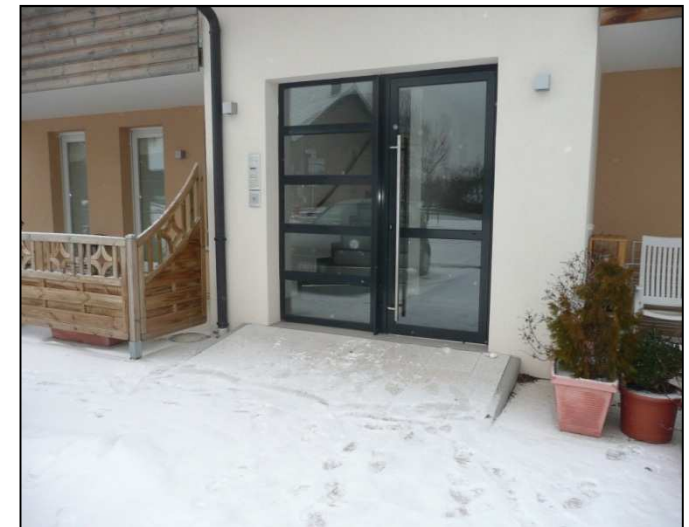
Pente > à 5% / Absence palier de repos / Position portier
