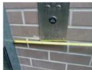
1. Commande de portier à moins de 0,40 m de l'angle formé avec la baie vitrée.
