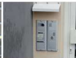
2. Portier à moins de 0,40 m du mur perpendiculaire.
