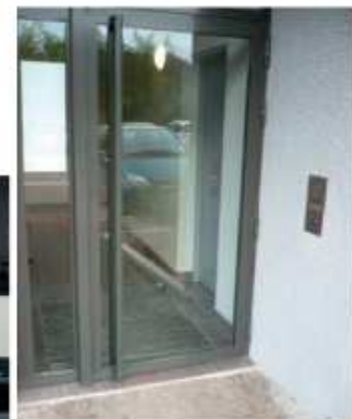
5. Absence de marquage des parties vitrées.
