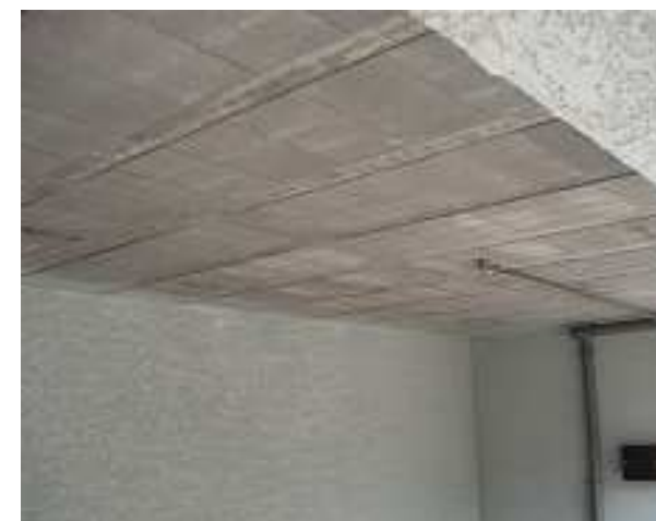
Absence d'isolant en plancher haut dans parc
